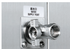
純水供給口(減圧弁付)
